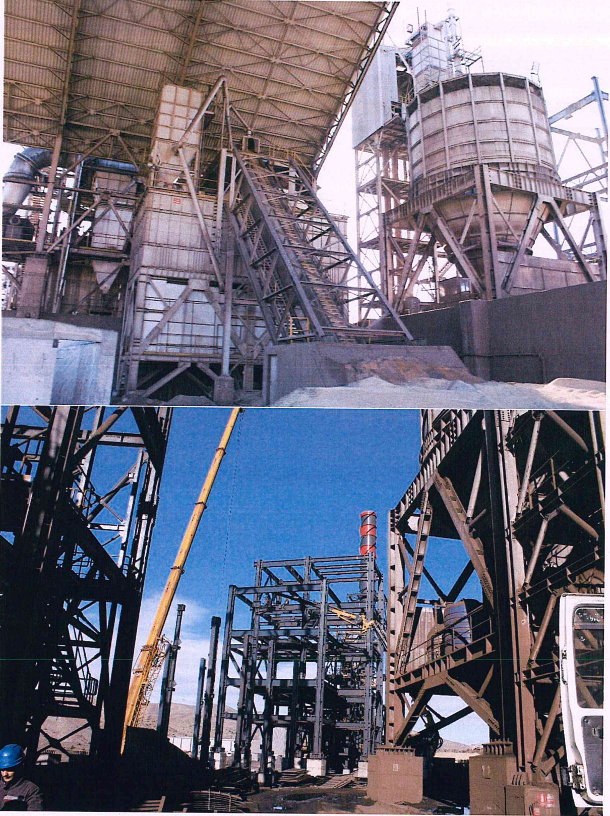
Fotoğraf 6. Hekimhan Siderit Kalsinasyon Tesisi Genel Görünümler- 4 (19.12.2023)
