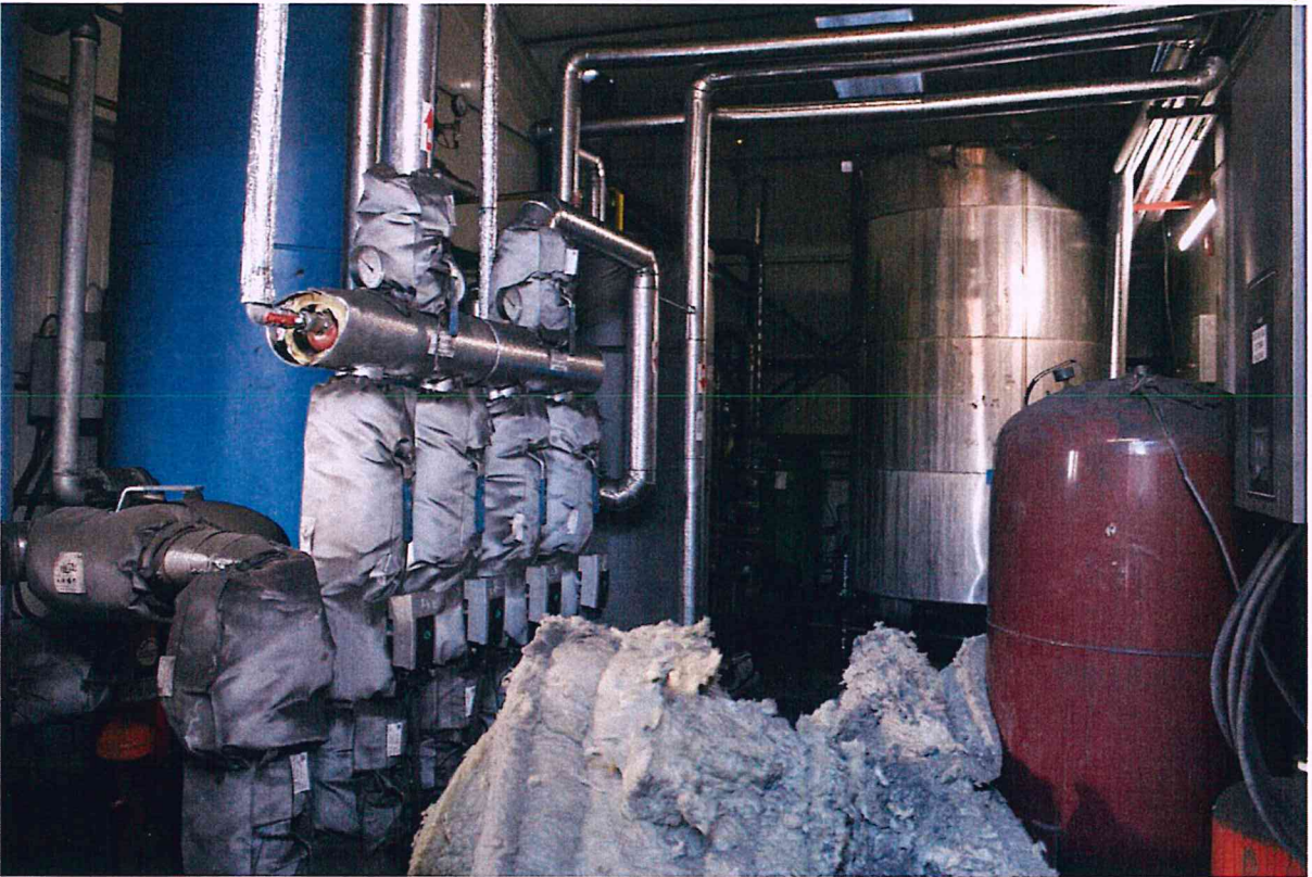
Fotoğraf 22. Fabrika Kullanım Suyu Arıtma Tesisi
