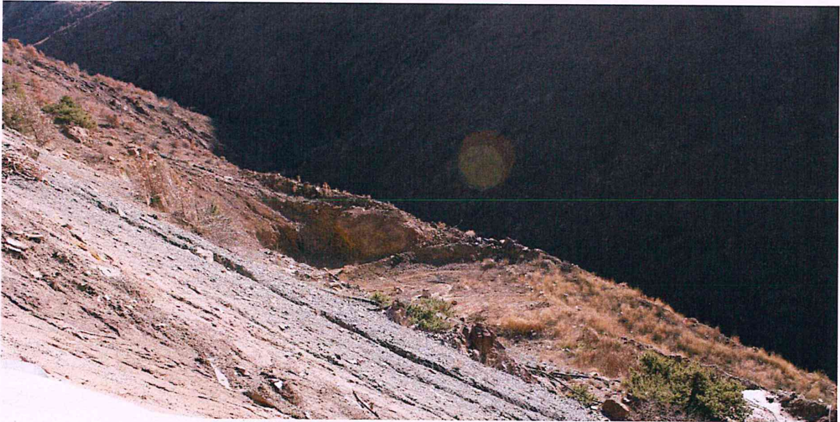
Fotoğraf 25. Güvenç Kırma Eleme Tesisi Foseptik Çukur
